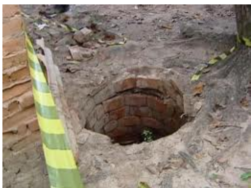
Figura 20 – Poço sem cobertura ou resguardo eficaz
