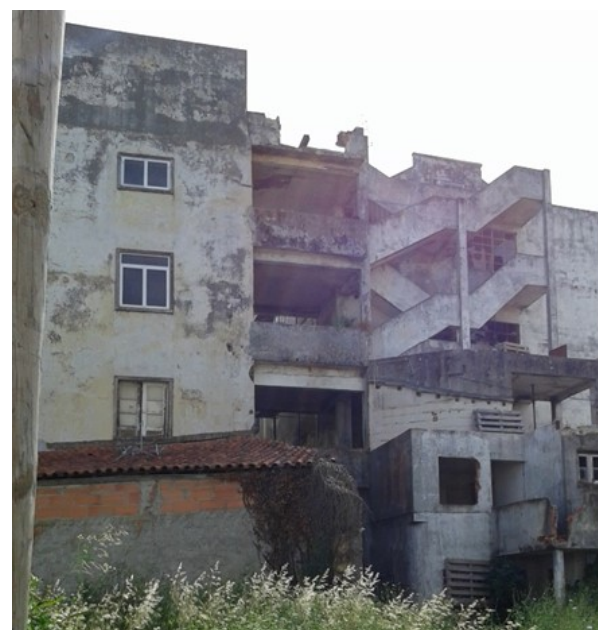
78 | Desagregação nas fachadas
