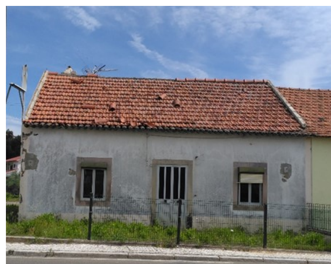
77 | Manchas e bolores na fachada
