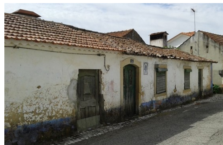
82 | Edifício com caixilharia em degradação
