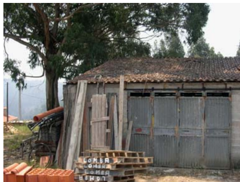
Figura 13 — Acumulação de material combustível junto à edificação.
